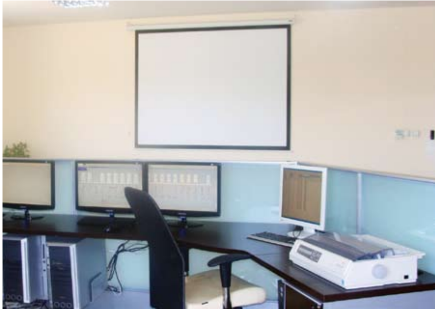
Ankara Sincan OSB Elektrik Kontrol Merkezi
