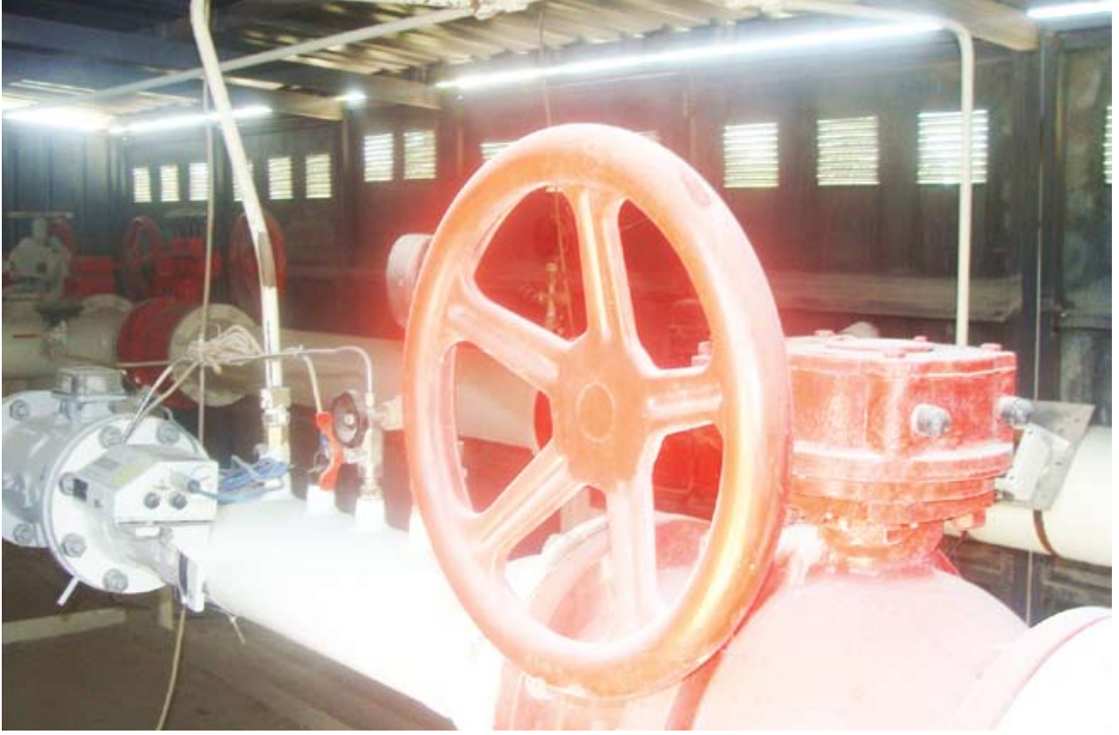
Ankara-Sincan OSB Doğal gaz Aktarım Merkezi
